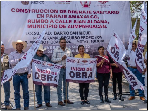
Ilustración 4.4.3 Infraestructura de drenaje y alcantarillado en municipio.Fuente: Fotografía de la Coordinación Municipal de Protección Civil (2026).
