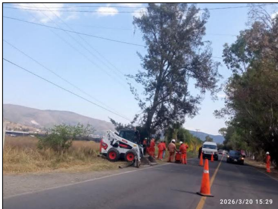
Ilustración. Infraestructura eléctrica en la carretera Zumpahuacán- Tenancingo..Fuente: Fotografía de la Coordinación Municipal de Protección Civil (2026).
