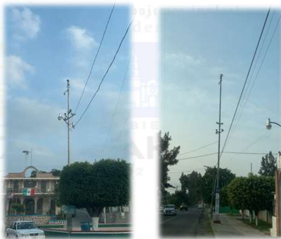
Imagen 179. Postes con Sistema de Alertamiento Sísmico.
